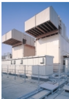
ガスエンジン3030kw×2 スチームタービン800kw×1
