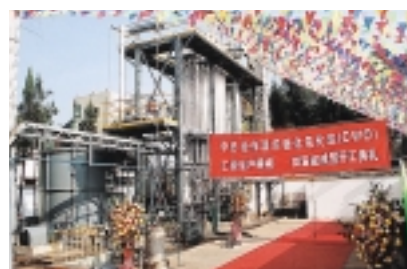
CWO評価プラント（能力：20m 3 /日）2001年3月1日竣工
