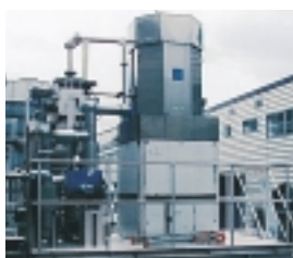
屋外型廃塩酸プラント
